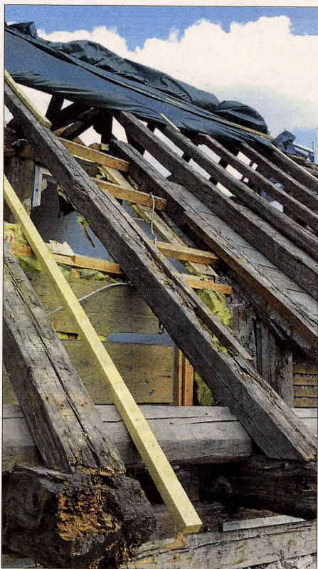
Morsches Tragwerk unterm Dach Foto: Stadt
